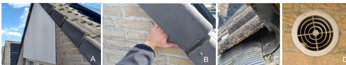
Figuur 8: Voorbeeld selectie van inspectiebevindingen met gegeven adviezen in het bijschrift. A) Dakpannen aan de voor- en achterzijden van de woningen sluiten (over de gehele rand) niet naadloos aan op de muren. Zwarte ratten kunnen dergelijke muren eenvoudig verticaal beklimmen. B) Een mensenhand kan hier grotendeels in, waardoor zelfs over de muur gevoeld kan worden. Zwarte ratten kunnen zich zo gemakkelijk begeven onder dakpannen of zelfs in de spouwmuur. Deze openingen bieden toegang tot potentiële nestellocaties. Bij enkele woningen is voelbaar dat een zeil de spouwopening aan de bovenzijde van de muur afdekt. Echter knaagt een zwarte rat hier gemakkelijk doorheen. Het verdient dan ook aanbeveling de openingen naar buiten te dichten, bijvoorbeeld door middel van staalwol. C) Opening onderaan het klappaam. Bij dergelijke klappamen zijn hoeken vaak niet volledig gedicht, waardoor zwarte ratten gemakkelijk (eventueel na het wegnemen van isolatiemateriaal) onder de dakpannen kunnen komen. Dergelijke openingen kunnen eenvoudig (vanuit het klappaam) worden gedicht met fijnmazig gaas, staalwol en soortgelijke middelen. D) Het ventilatierooster heeft openingen groter dan 0,5 cm en is van plastic. Muizen, allicht ook jonge ratten, passen door de openingen of kunnen het rooster kapot knagen om zo een directe toegang naar binnen. Vervang dergelijke roosters voor roosters van RVS, met openingen kleiner dan 0,5 cm.
