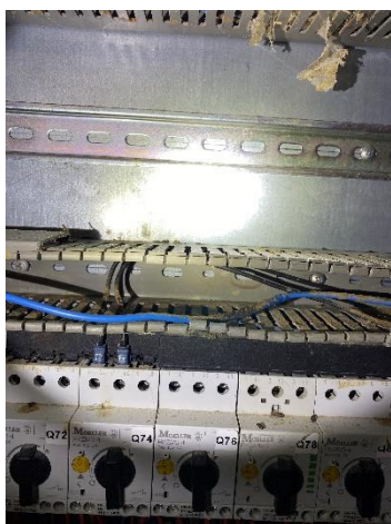
Figuur 14. Buiksmeeisporen op kabels in verdeelkast > duidt op veel activiteit.
