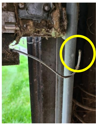
Figuur 24. Knaagschade bekabeling roldeur.
