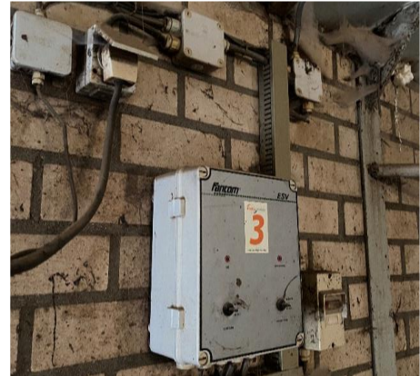
Figuur 28. Elektra in de stal langs de wand. Kabels gedeeltelijk toegankelijk voor ratten/muizen.
