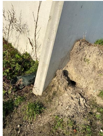
Figuur 5. Rattenhol naast damwand kuil.
