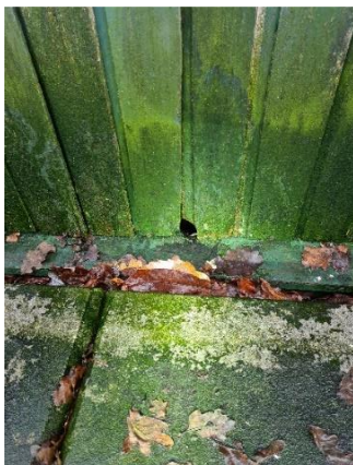
Figuur 23. Gat in deur geknaagd.
