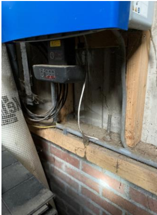
Figuur 20. Kabels omvormer zonnepanelen toegankelijk voor ratten en muizen.
