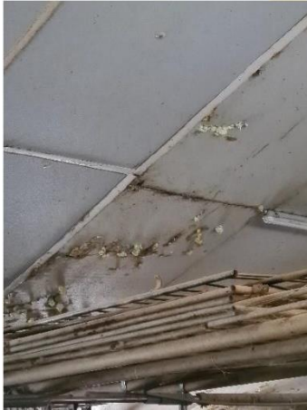
Figuur 3. Knaagschade aan plafond en isolatiemateriaal. Kabels zijn weggewerkt achter het plafond.
