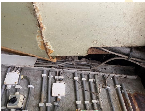
Figuur 13. Bekabeling in gedeeltelijk gesloten kabelgoot.
