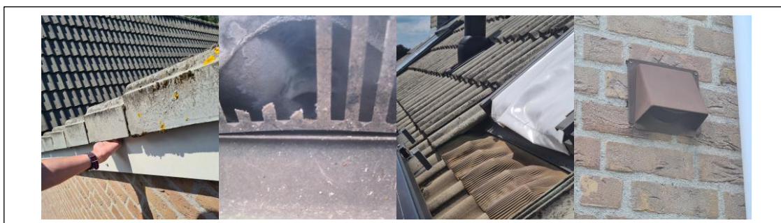
Figuur 6. Voorbeeld selectie van inspectiebevindingen met gegeven adviezen in het bijschrift. A) Dakpannen aan de voor- en achterzijden van de woningen sluiten (over de gehele rand) niet naadloos aan op de muren. Zwarte ratten kunnen dergelijke muren eenvoudig verticaal beklimmen. Een menselijke hand kan hier grotendeels in, waardoor zelfs over de muur gevoeld kan worden. Zwarte ratten kunnen zich zo gemakkelijk begeven onder dakpannen of zelfs in de spouwmuur. Deze openingen bieden toegang tot potentiële nestlocaties. Bij enkele woningen is voelbaar dat een zeil de spouwopening aan de bovenzijde van de muur afdekt. Echter knaagt een zwarte rat hier gemakkelijk doorheen. Het verdient dan ook aanbeveling de openingen naar buiten te dichten, bijv. door middel van staalwol. B) De plastic vogelschroot onder de dakpannen is bij de meeste woningen in dit blok op tenminste enkele plekken (voornamelijk op de hoeken) doorgeknaagd. Vervang de plastic vogelschroot door een metalen variant. C) Opening onderaan het klappaam. Bij dergelijke klapparamen zijn hoeken vaak niet volledig gedicht, waardoor zwarte ratten gemakkelijk (eventueel na het wegnagen van isolatiemateriaal) onder de dakpannen kunnen komen. Dergelijke openingen kunnen eenvoudig (vanuit het klappaam) worden gedicht met fijnmazig gaas, staalwol e.d. middelen. D) Het ventilatierooster heeft een te grote maaswijdte. Vervang dergelijke roosters voor roosters van RVS, met openingen kleiner dan 0,5 cm.
