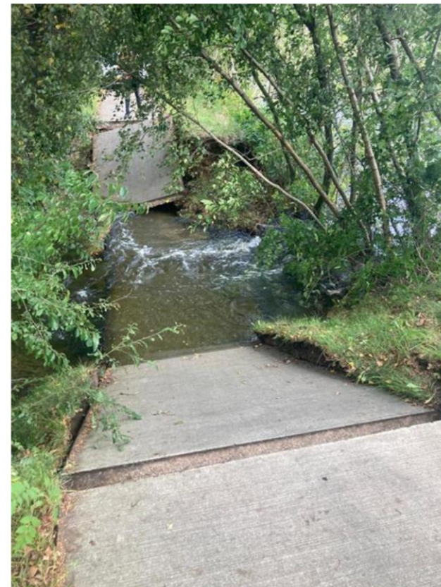
Figuur 1 Bres in de kade Apeldoorns Kanaal door graverij van de bever (september 2023)
